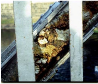
Figura 8.9 – Exemplo de corrosão por lixiviação seletiva
