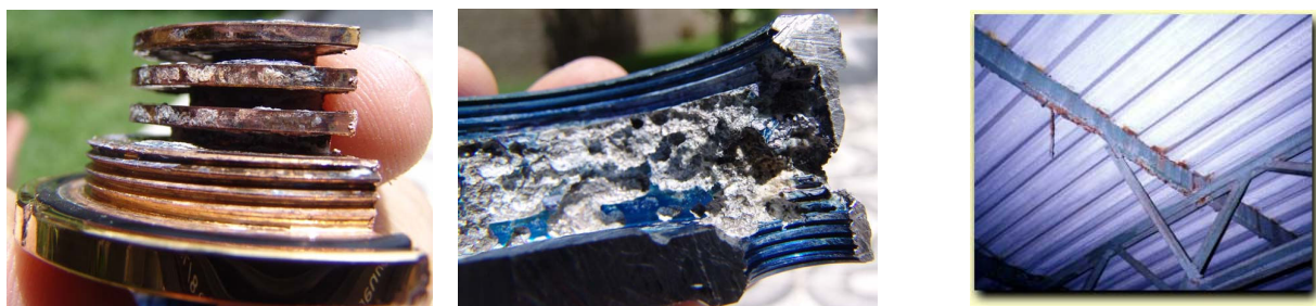
Figura 8.5 – Exemplo de corrosão galvânica
