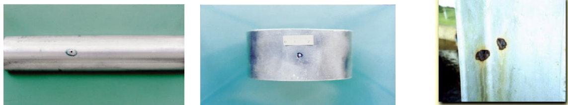
Figura 8.7 – Exemplo de corrosão localizada
