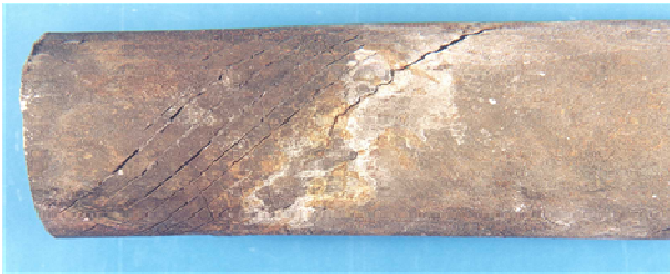
Figura 8.11 – Exemplo de corrosão sob tensão
